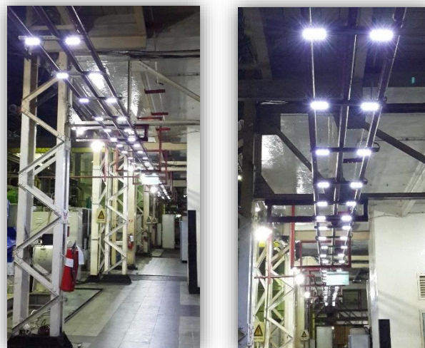
Gambar 3.7 Instalasi Lampu LED Produksi PLTMH
